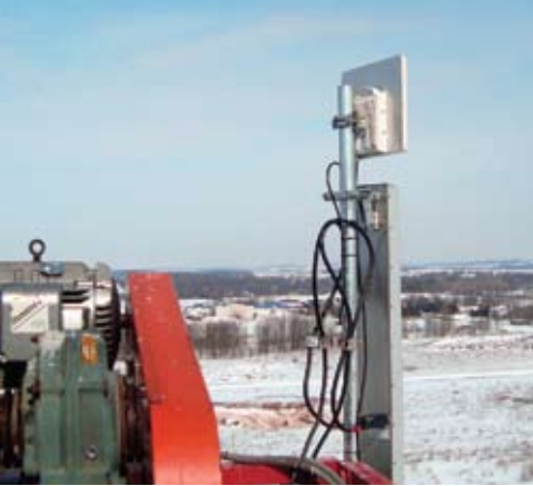
WiMAX backhaul, USA
